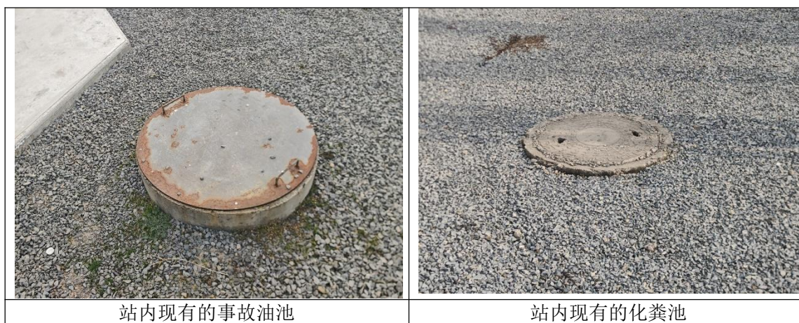
图 2 工程站内环保设施现状
