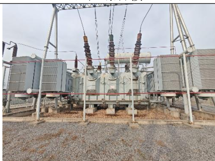
已建 1#主变压器
