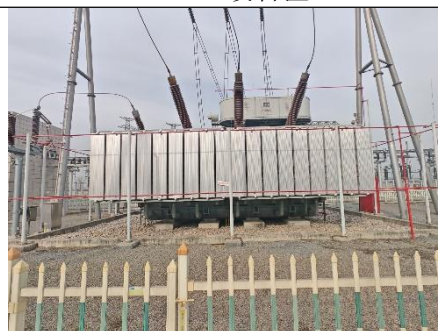
已建 2#主变压器
